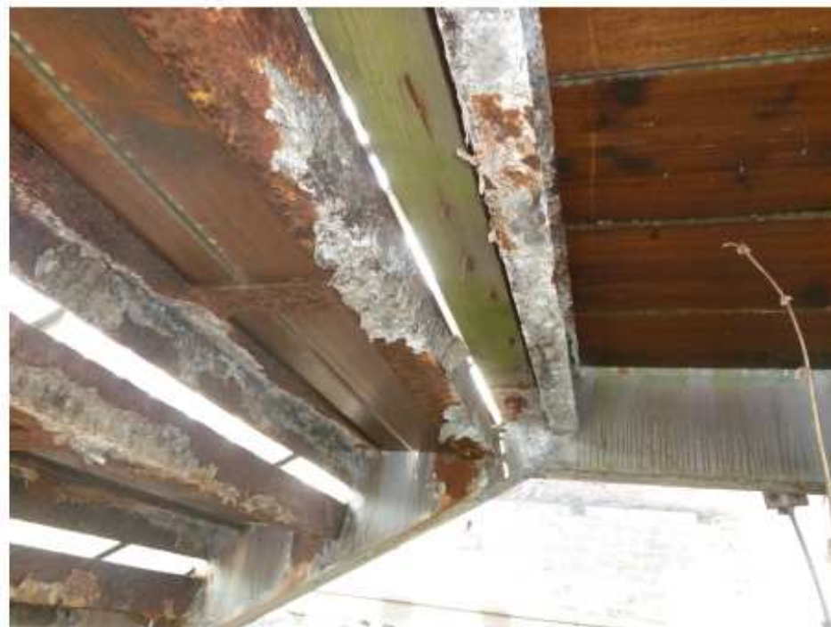
6 detail koroze ocelových prvků v pohledu .JPG
