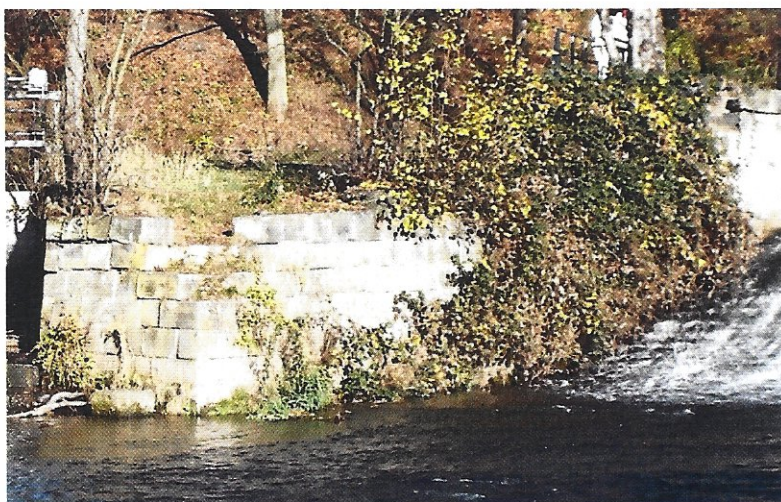
Poškození PB zavázání jzu do břehu
