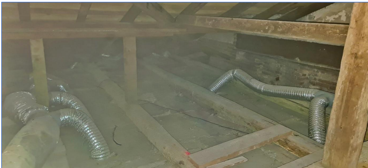
OBR.Č. 18 - BIOTICKÁ DESTRUKCE STROPNÍCH TRÁMŮ AKTIVNÍMI LARVAMI DŘ. HMYZU - TESAŘÍKOVITÍ - INDEX C - D
