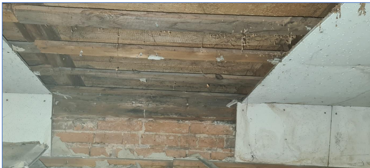
OBR.Č. 5 – STAV POZEDNICE V KONSTR. SPOJI S KROKVEMI (VLEVO OD VST. SCHODIŠTĚ) – SONDA 2 – INDEX C
