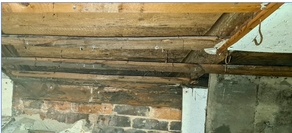
OBR.Č. 4 – STAV POZEDNICE V KONSTR. SPOJI S KROKVEMI (VLEVO OD VST. SCHODIŠTĚ) – SONDA 1 – INDEX C
