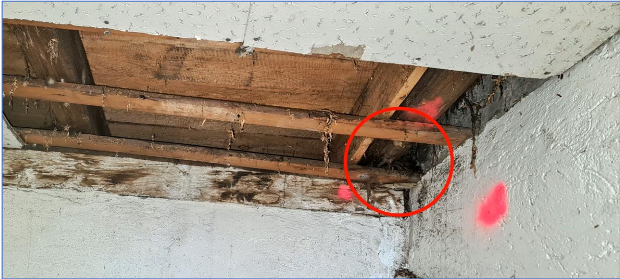
OBR.Č. 9 – STAV POZEDNICE V KONSTR. SPOJI S KROKVEMI (VLEVO OD VST. SCHODIŠTĚ) – SONDA 5 – INDEX D
