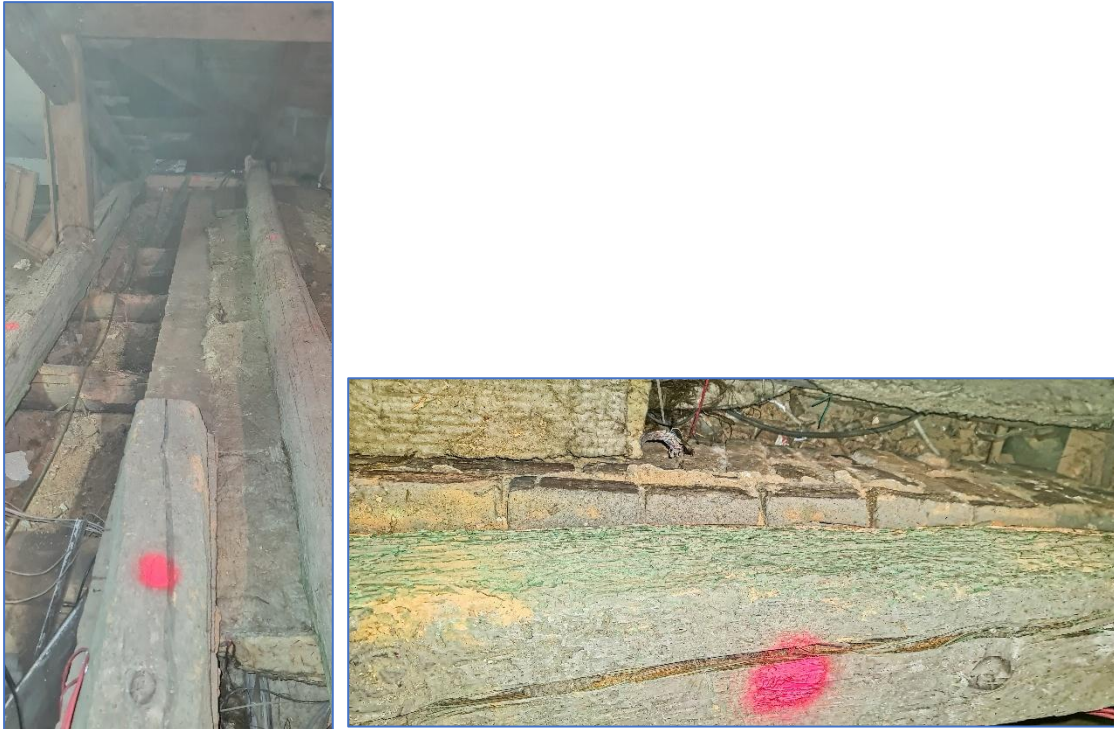
OBR.Č. 13 - 14 - BIOTICKÁ DESTRUKCE STROPNÍCH TRÁMŮ AKTIVNÍMI LARVAMI DŘ. HMYZU - TESAŘÍKOVITÍ - INDEX C - D
