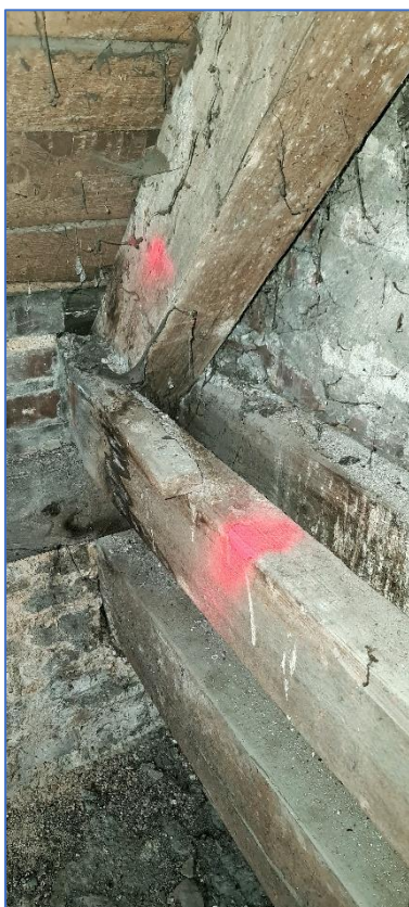
OBR.Č. 33 – ZADNÍ LEVÁ POZICE (VYVÝŠENÁ ČÁST) – DETAIL BIOTICKÉ DESTRUKCE KONSTR. SPOJE KROKVE – KLEŠTINA – INDEX D – ODBĚR VZORKU VZ1
