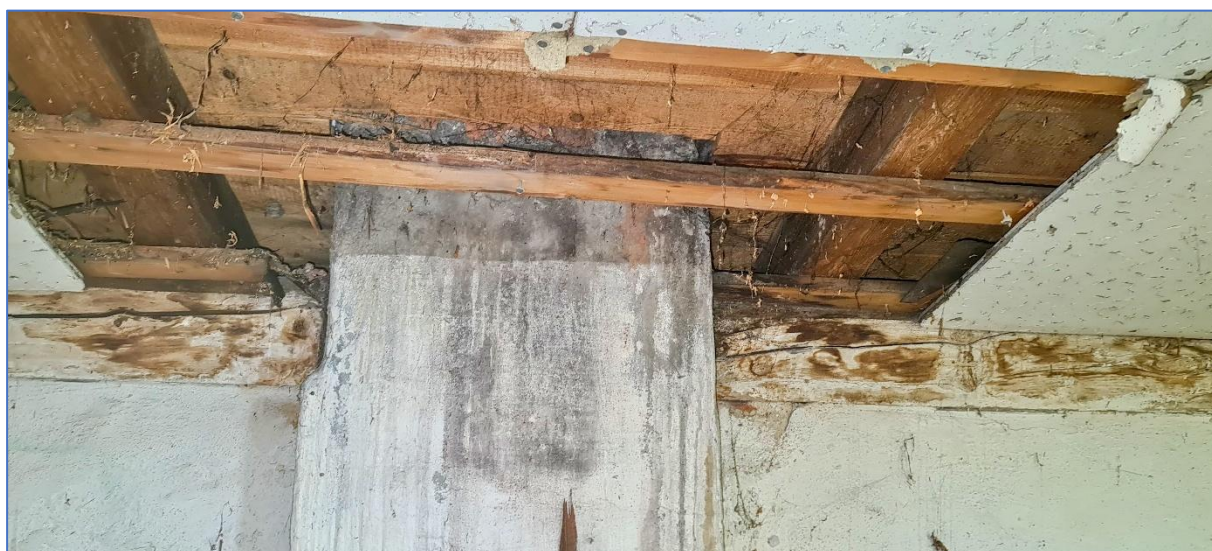
OBR.Č. 8 - STAV POZEDNICE V KONSTR. SPOJI S KROKVEMI (VLEVO OD VST. SCHODIŠTĚ) - SONDA 4 - INDEX C
