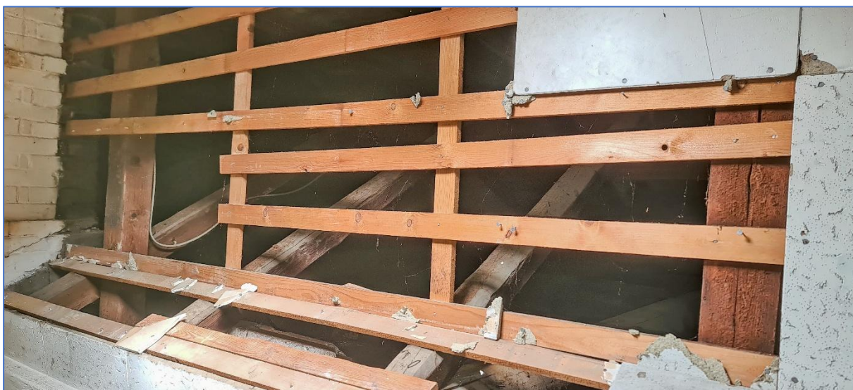
OBR.Č. 11 - POHLED DO PŮDNÍHO PROSTORU PO ODSTRANĚNÍ KRYCÍCH ŠABLON
