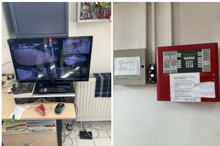
Obrázek 7 - výstup CCTV na monitor + ústředna EPS
