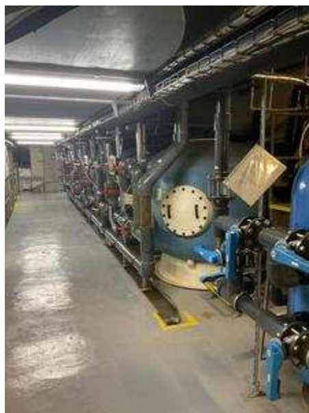
Obrázek 14 - technologie čerpání, úpravy a chlorování vody v hlavním bazénu
