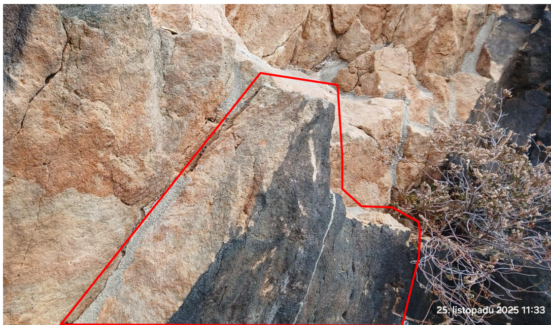
D) Detail nebezpečného skalního objekt č. II (foto Jaroslav Dunovský)
