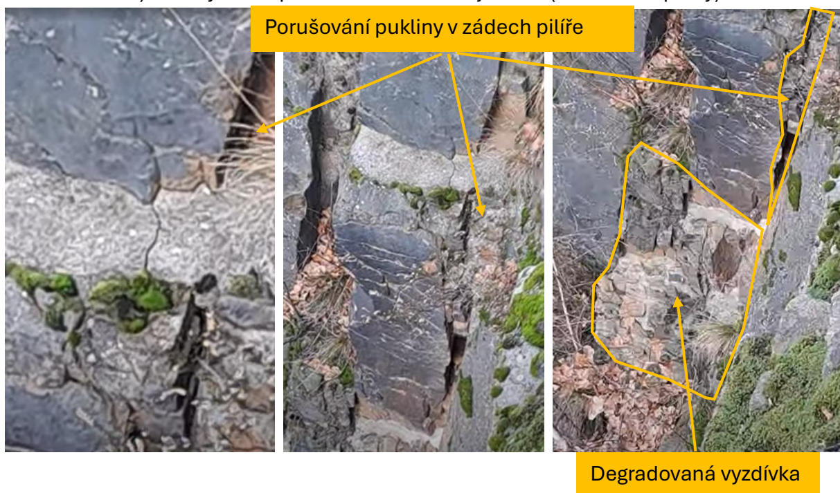
B) Detaily nebezpečného skalního objekt č. I (foto autor zprávy)
