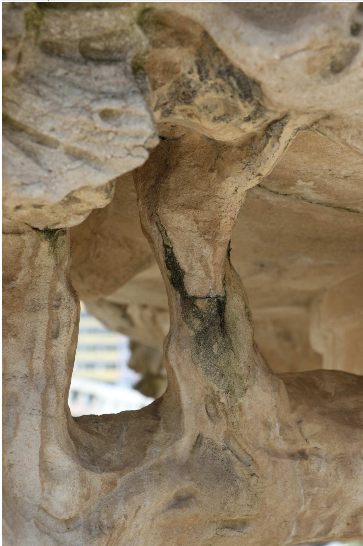
Biokoroze v závětrných místech, degradace vápence vydrolením
