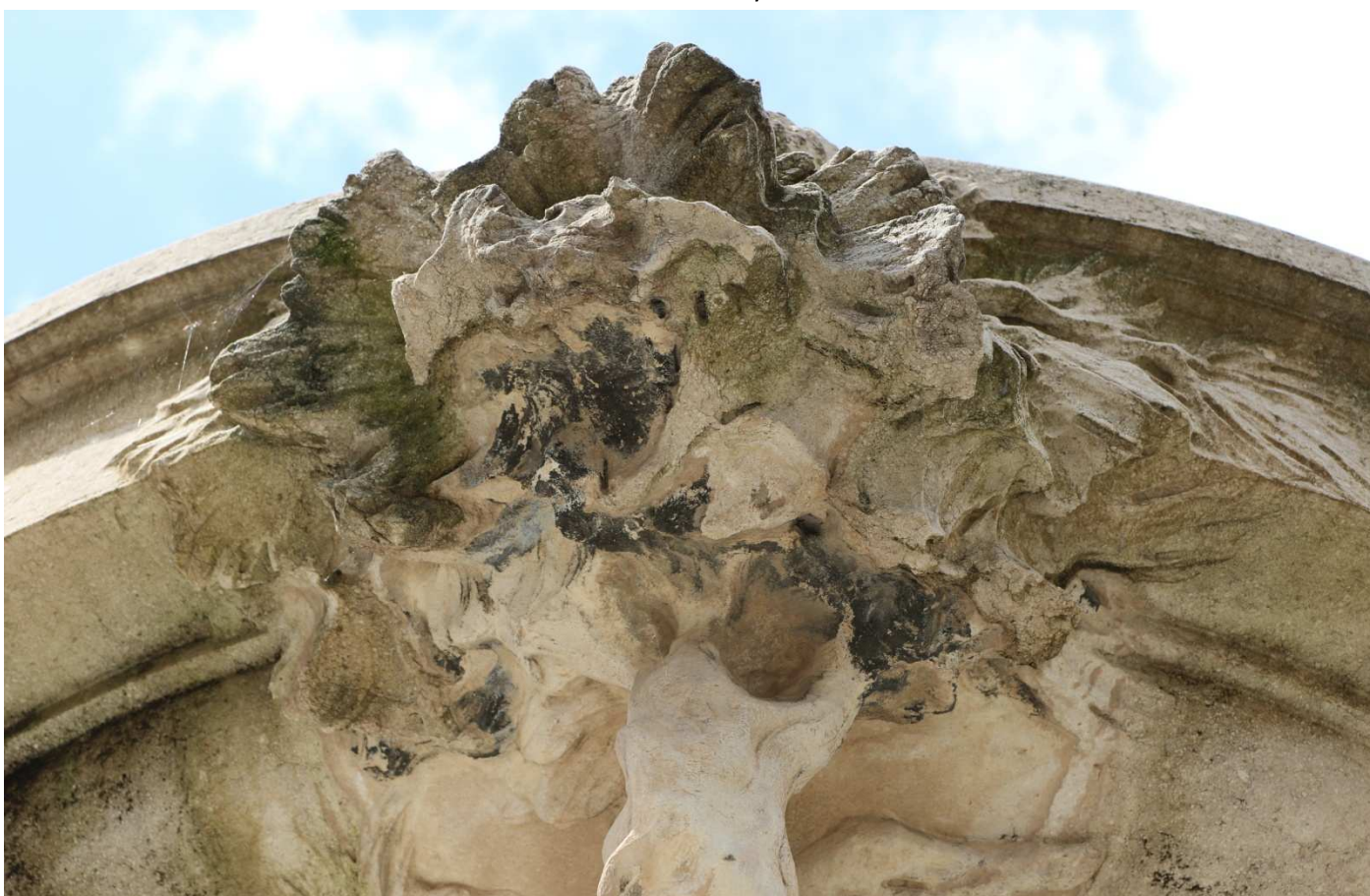
Biokoroze, sádrovcové krusty
