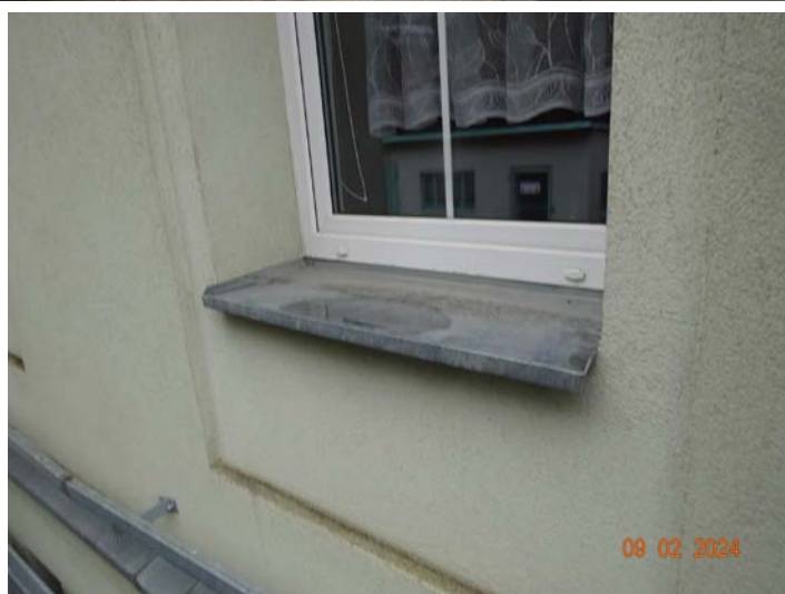
Objekt B – vadný sklon parapetu
