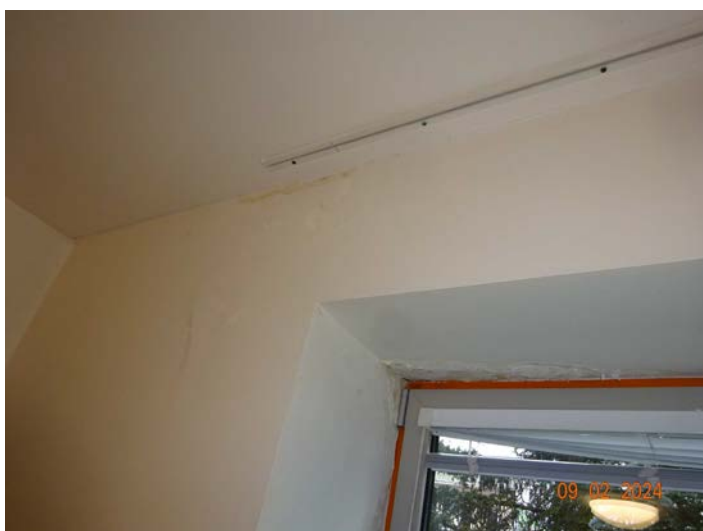
Místnost C112 – zatečení na strop
