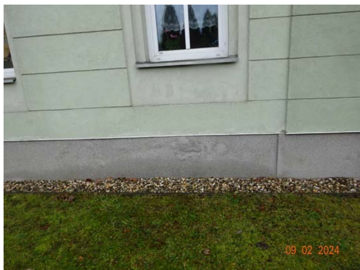
Objekt B – vlhká část jižní stěny
