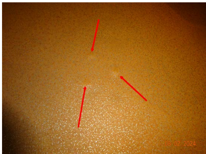
Místnost 205 – nerovnosti – nečistoty pod podlahou
