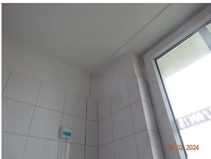
Místnost B115 – trhliny ve stěně a stropu na styku původních a nových konstrukcí
