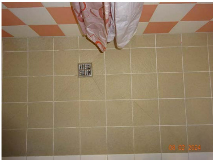
Místnost B308 – neutěsněné spáry v podlaze sprchy
