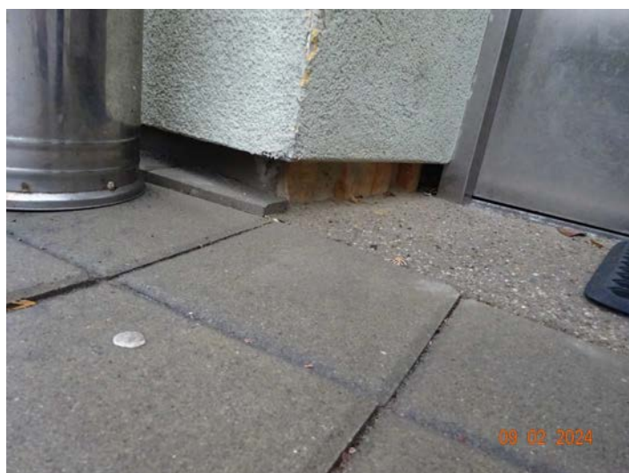
Objekt B – východní stěna . vstup do výtahu – odhalené cihly
