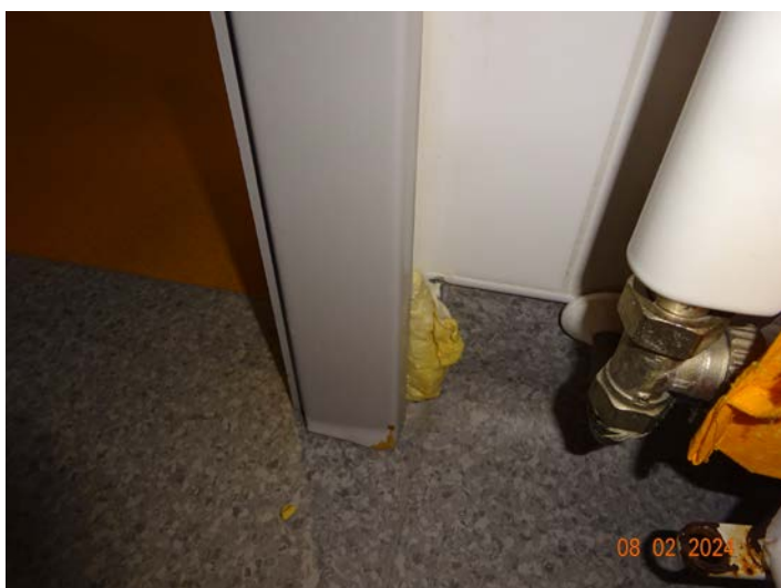
Koupelna B112 – vlhkostí poškozená obložka dveří, zapravení montážní pěnou
