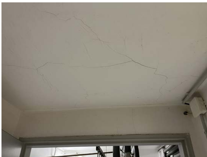
Místnost A 0109 – trhliny v omítce stropu
