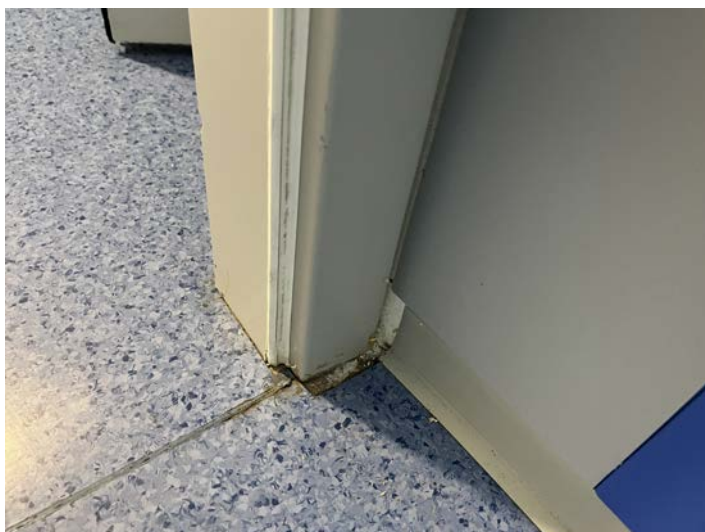
Místnost A302 – vadné provedení soklu
