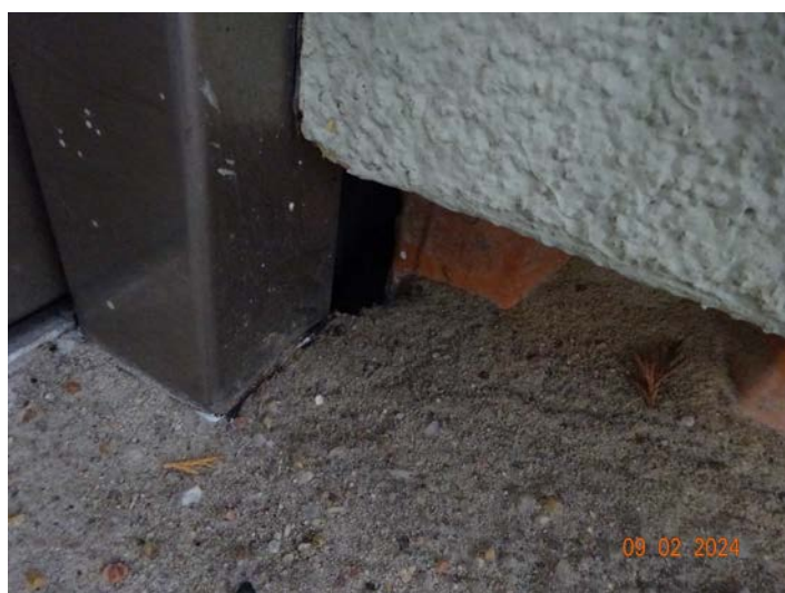
Objekt B – východní strana – díra u rámu dveří koupelny, odhalené cihly
