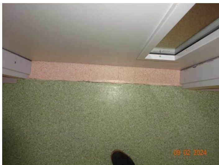
Objekt C – obecný problém napojení krytiny chodby na krytinu v pokoji – spára s možností zatékání vody
