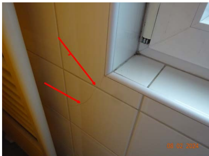
Koupelna B113 – trhlina v keramickém obkladu pod oknem
