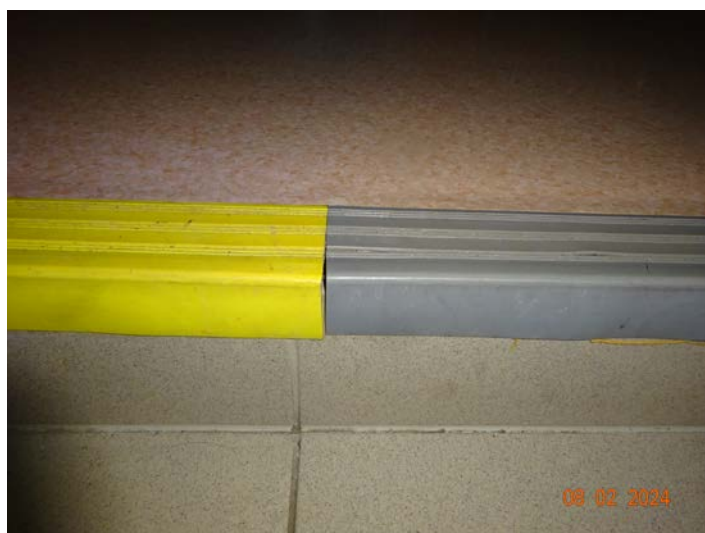
Místnost B104 – schodiště – volná hranová lišta
