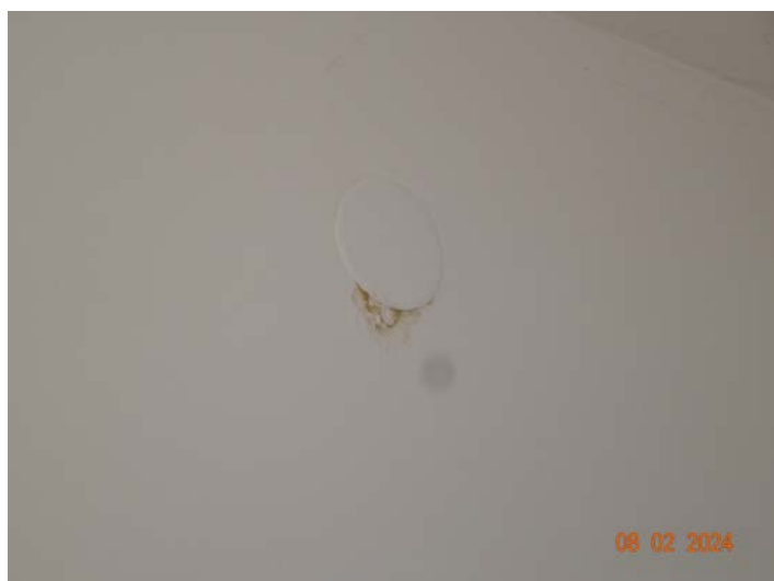
Místnost B205 – stopa vytékající vody z elektroinstalační krabice
