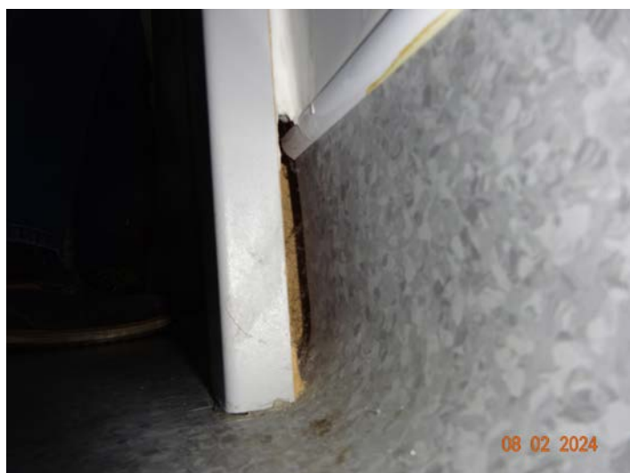
Místnost 115 – vlhkostí poškozená obložka zárubně dveří, netěsné napojení obložky na stěnu
