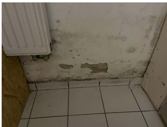
Místnost A013 – vlhké stěny
