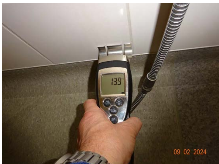
Část C – koupelna – vlhkost zdiva za keramickým obkladem 13,9%
