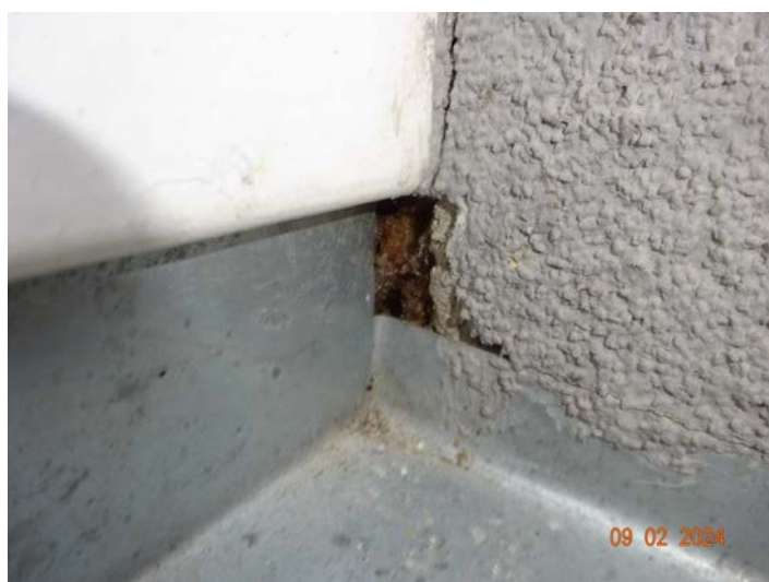
Objekt C – okno kuchyně – díra u parapetu
