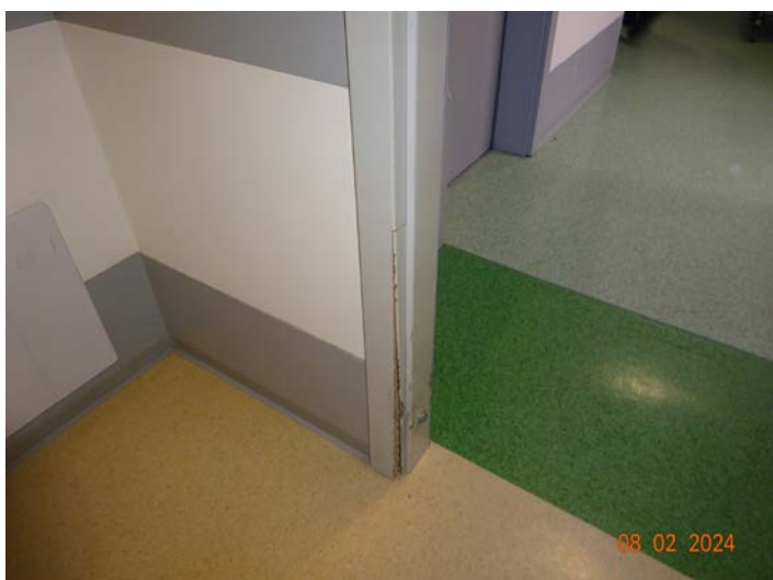
Chodba B001 – poškozená obložka dveří do části C
