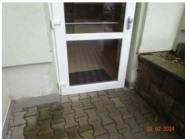
Objekt B – jižní strana – vlhké stěny u nouzového východu
