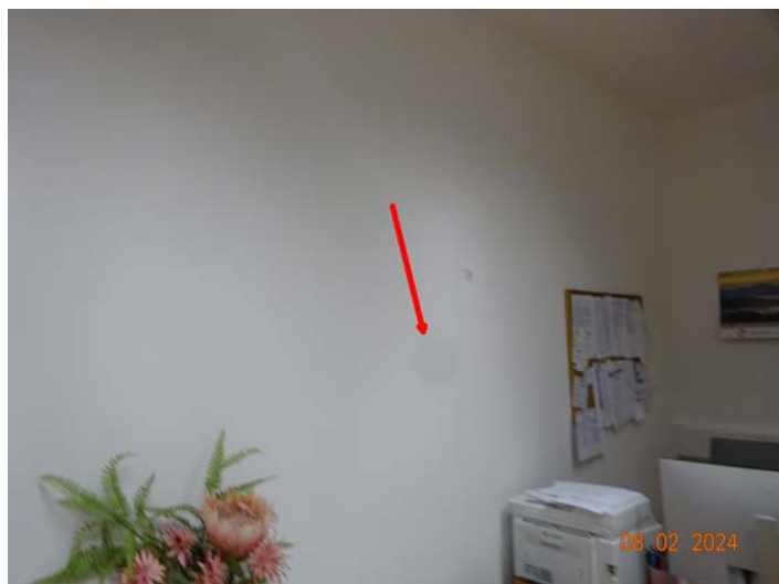
Sesterna B014 – stopa vlhkosti na stěně k myčce nádobí, stěna vyschlá
