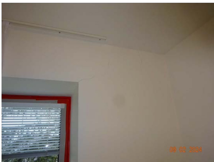
Místnost C119 – „oprava“ netěsného okna lepenkou
