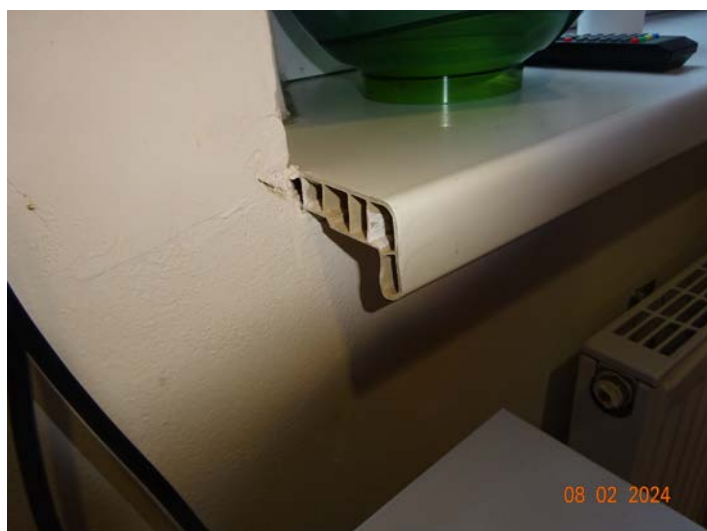
Místnost B210 – chybějící koncovky vnitřního parapetu
