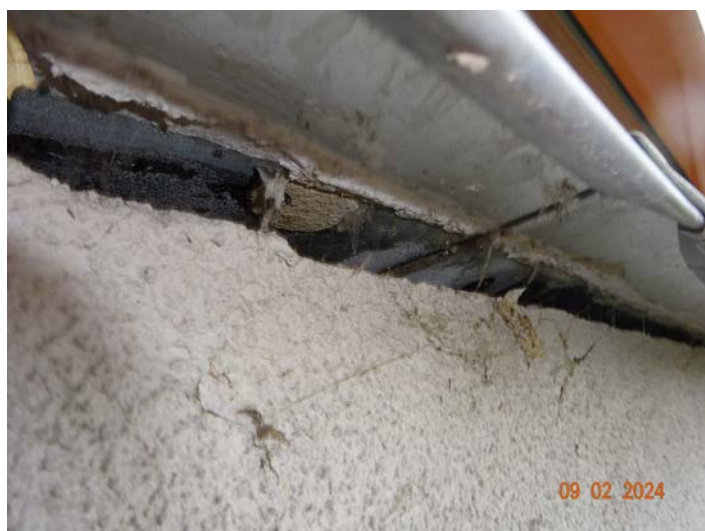
Objekt C – jižní strana – uvolněný parapet
