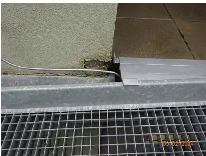
Objekt B – napojení rampy na zdivo, zatékání vody a vlhnutí stěn
