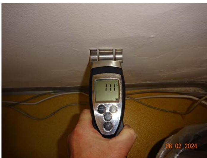
Sesterna B014 – vlhkost stěny až 11,1% nad podlahou
