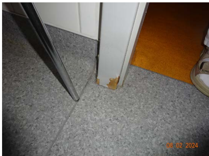
Místnost B115 – vlhkostí poškozená obložka zárubně dveří
