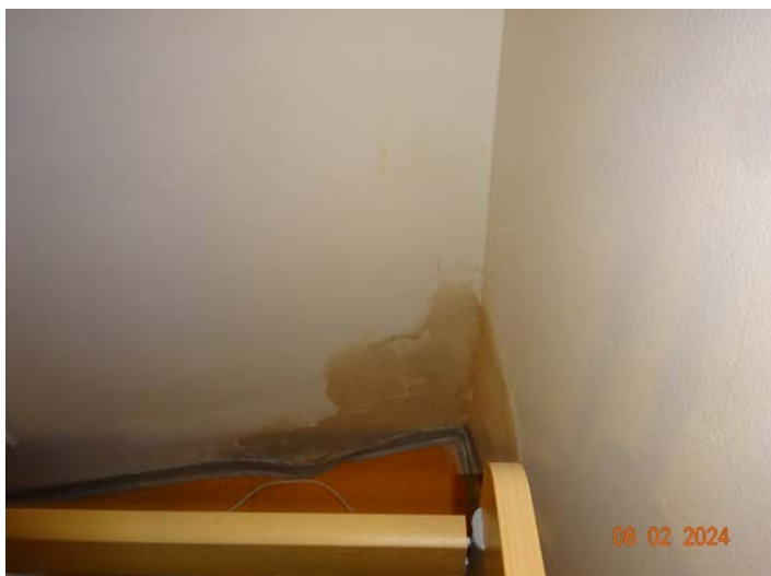
Místnost B111 – vlhká stěna
