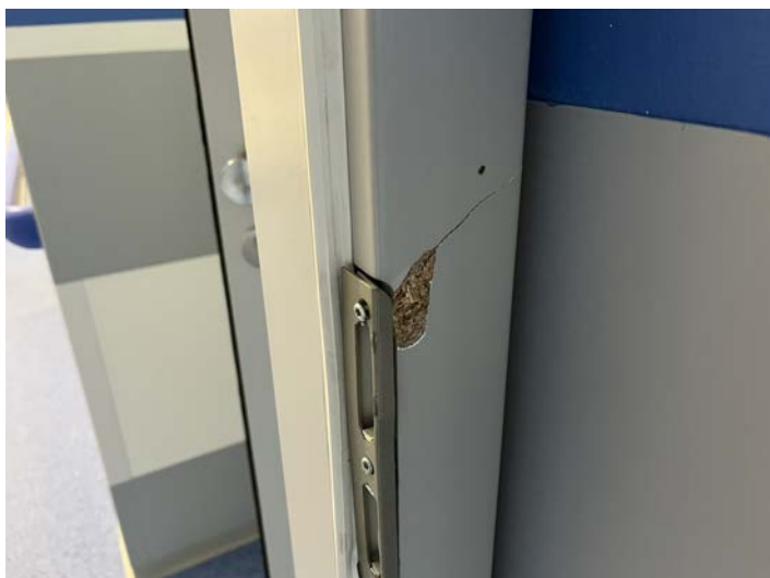
Místnost A302 – poškozené kování dveří
