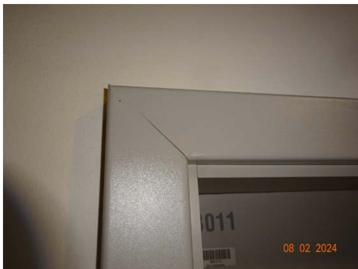
Místnost B011 – deformace zárubně
