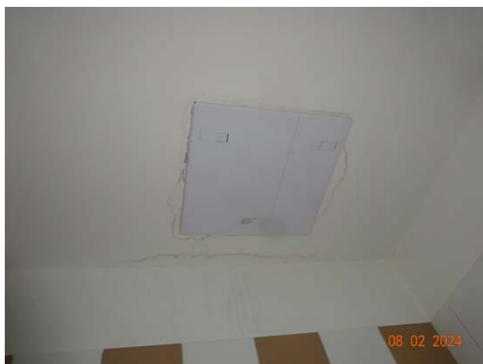
Koupelna B006 – zatékání kolem revizních dvířek na strop
