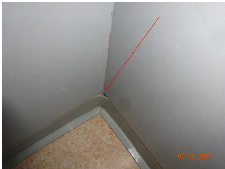
Typická vada provedení, opakující se ve všech místnostech – netěsný sokl v rozích místností
