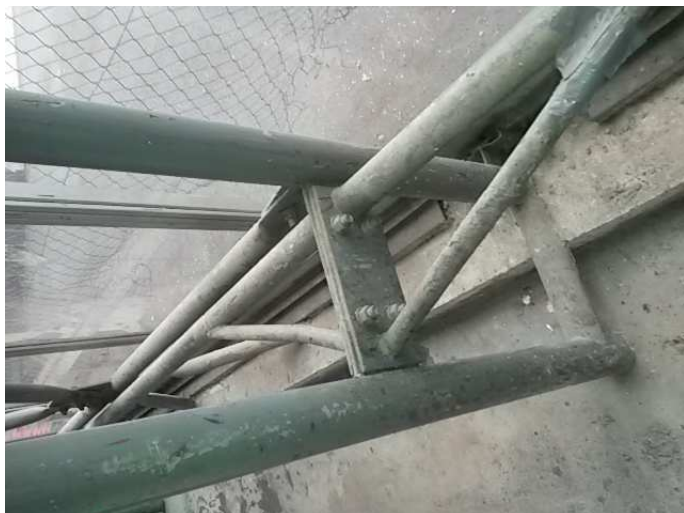
spojení horizontální ztužidla, šroubový spoj, poškozené nátěry
