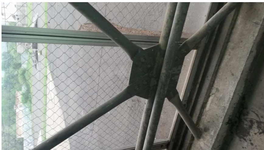
vertikální ztužidlo, poškozené nátěry
