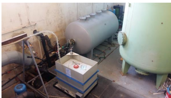
Obr. 39 Fotografie z místního šetření, pohled do strojovny úpravy vody v Aquaparku Děčín
