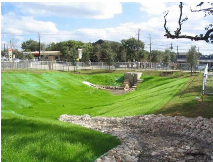
Obr. 27 Suché retenční dešťová nádrž [86]
