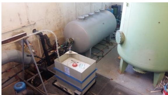
Obr. 40 Fotografie z místního šetření, pohled do strojovny úpravy vody v Aquaparku Děčín
