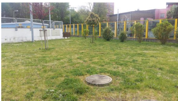
Obr. 50 Fotografie z místního šetření, pohled na odtokové odpadní potrubí zaústěné do řeky Ploučnice
