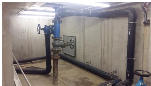
Obr. 45 Fotografie z místního šetření, pohled na příslušenství zhlaví vrtu v Aquaparku Děčín
