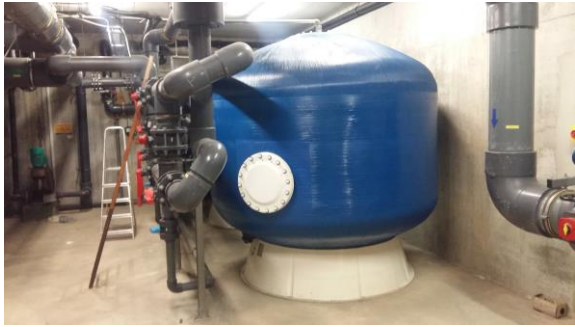
Obr. 46 Fotografie z místního šetření, pohled do strojovny úpravy vody s vrtem v Aquaparku Děčín
