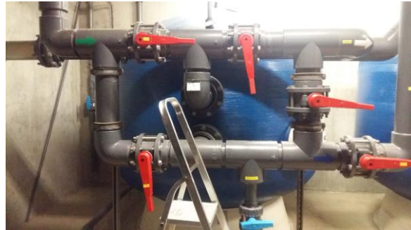
Obr. 47 Fotografie z místního šetření, pohled do strojovny úpravy vody s vrtem v Aquaparku Děčín
